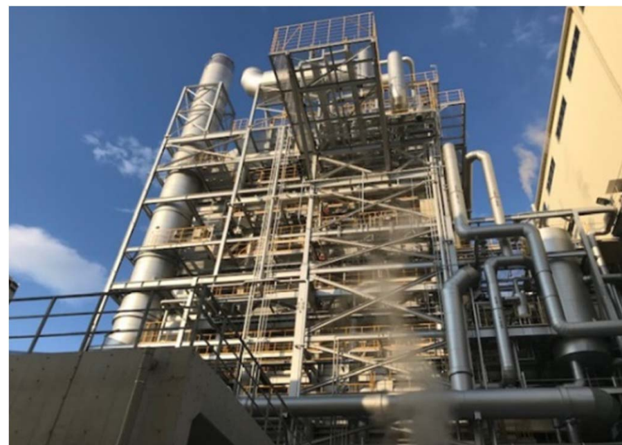
東三河バイオマス発電所
